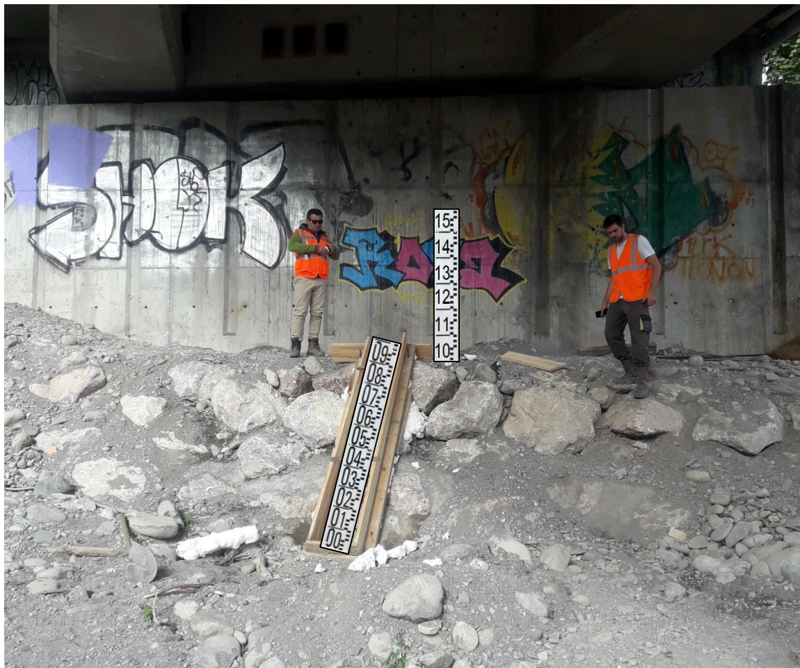
Montages de l'installation de l'échelle limnimétrique sur la pile du Pont de Dranse en rive gauche
