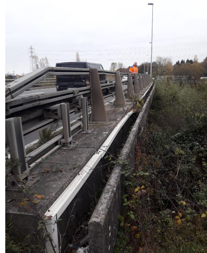
RD 1005 côté venue des eaux de la Dranse, PR 24-640 (5ieme pilier au niveau du personnel du Dpt 74)
