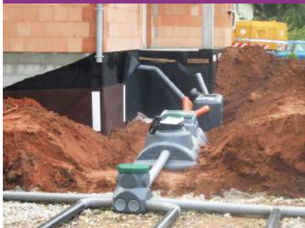
Fosse toutes eaux
