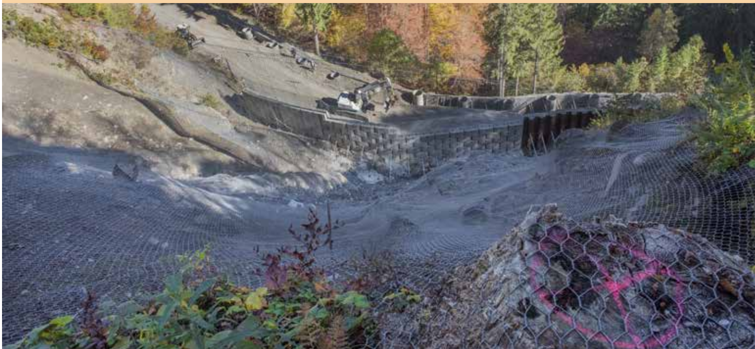
Zone d'éboulement vue de dessus.
