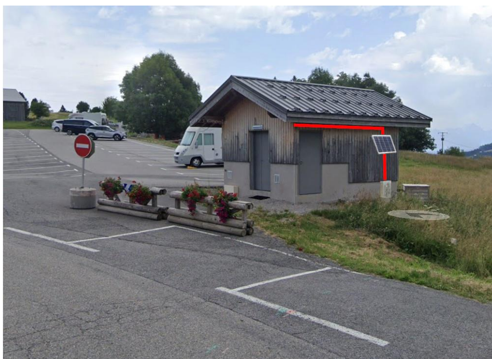
Implantation Panneau solaire et coffret de pilotage Façade Sud
